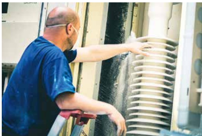
Obtáčanie podperného izolátora
